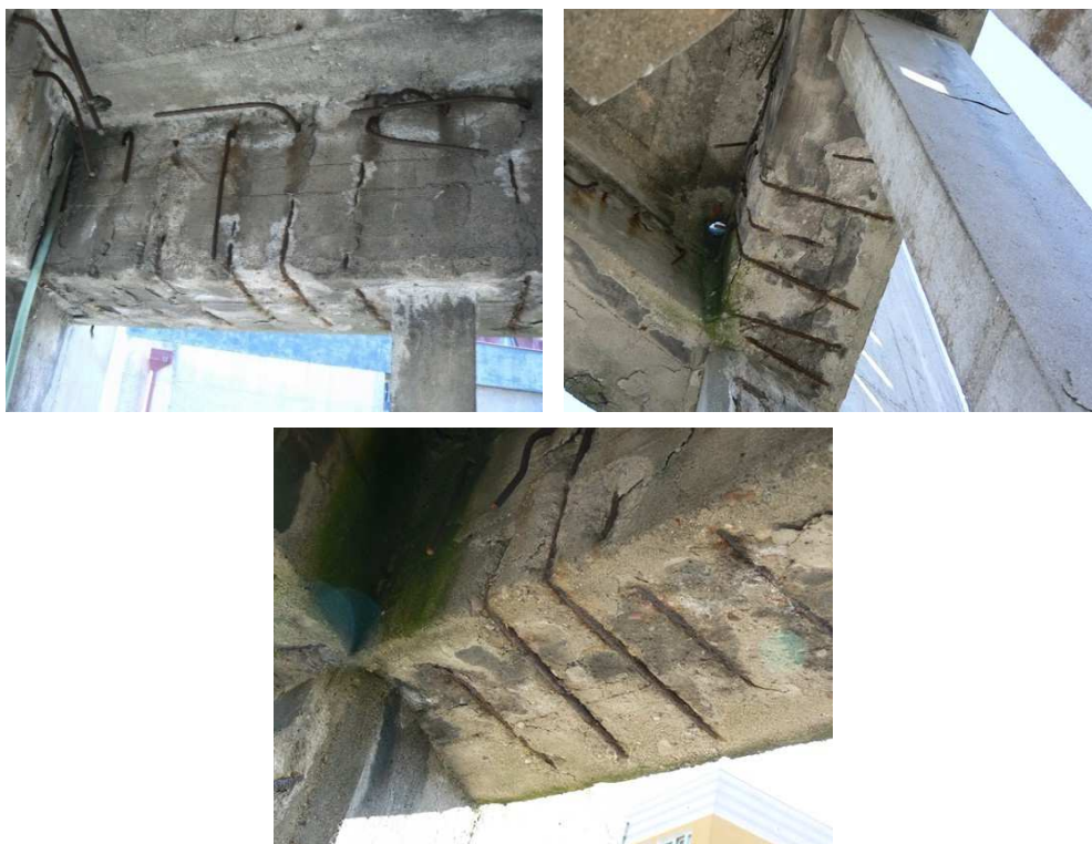
Rys. 4. Przykładowe uszkodzenia betonowych rygli – ubytki betonowej otuliny oraz korozja prętów zbrojeniowych
