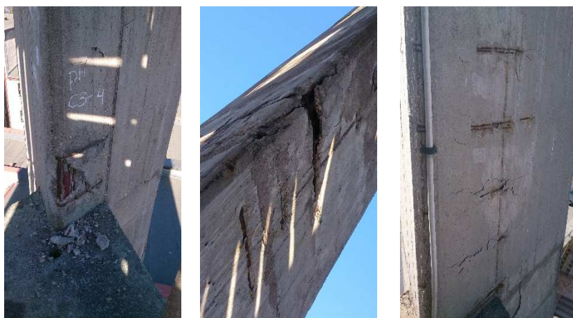
Rys. 3. Przykłady typowych uszkodzeń żelbetowych słupów wieży dzwonnicy – odspojenia i ubytki betonowej otuliny i korozja prętów zbrojeniowych
