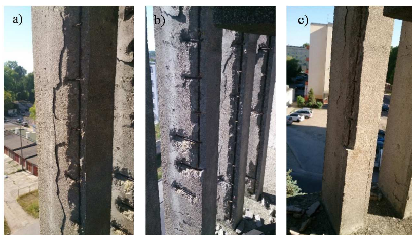
Rys. 5. Przykładowe uszkodzenia prefabrykowanych słupków – ubytki betonowej otuliny oraz korozja prętów zbrojeniowych
