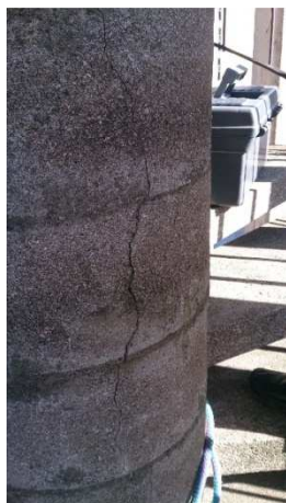
Rys. 6. Zarysowane prefabrykaty stopni schodów spiralnych prowadzących na szczyt wieży
